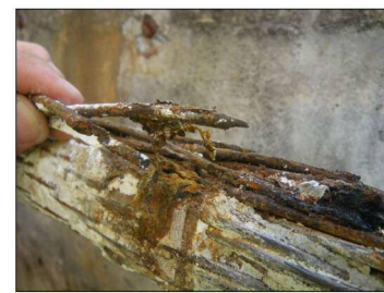
写真-4 腐食状況
