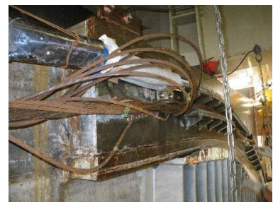
写真-12 鋼より線のばらけ状況
