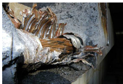
写真-3 グラウト未充填状況
