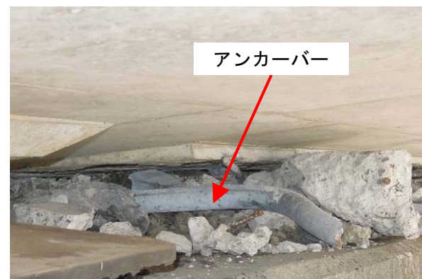
写真-4 変形したアンカーバー
