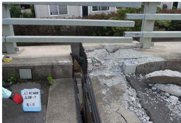
写真-2 伸縮装置の損傷 (A2 橋台)
