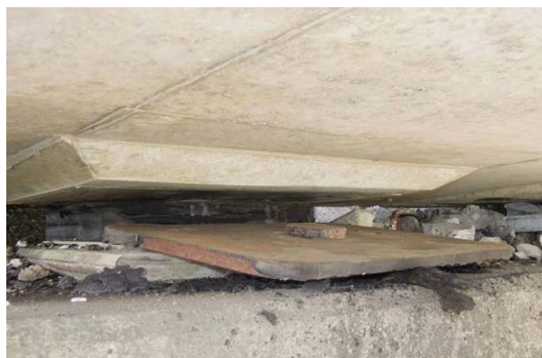
写真-3 支承の損傷
