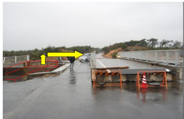
写真-1 被災直後の状況
