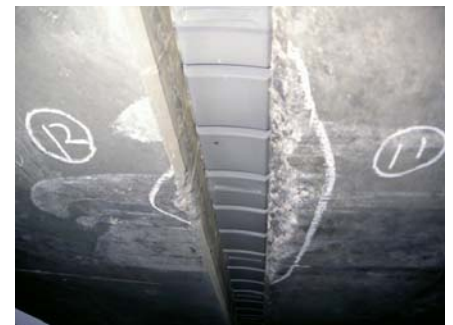
写真-4 主桁下面損傷状況
