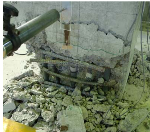
写真-3 柱基部損傷状態 (PPC2-2)
