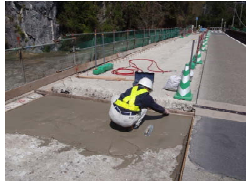
写真-2 施工時に発見した不具合の対処
