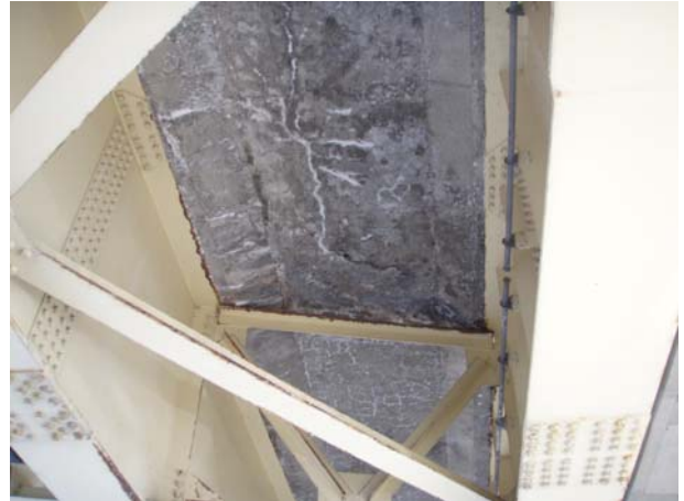
写真-1 コンクリート床版損傷状況
