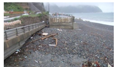
写真-1 被災後の桁移動状況
