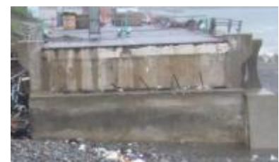
写真-2 被災後の左岸橋台の状況
