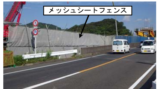
写真-3 メッシュシートフェンス
