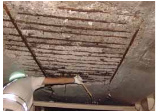
写真-1 床版下面の劣化状況
