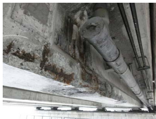
写真-1 PC桁の局所的な劣化 (排水管からの漏水)
