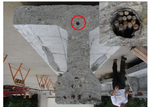
写真-3 上縁定着ケーブル定着部付近の空隙
