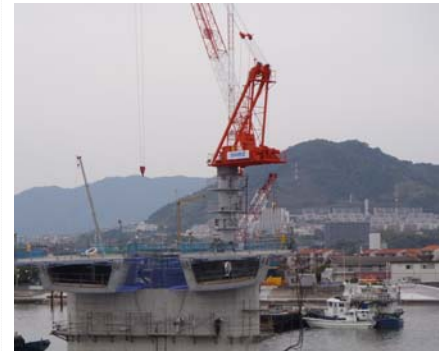
写真-9 P2 タワークレーン
