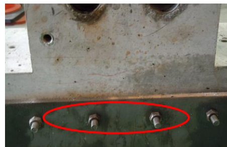
写真-2 右ブロック基部ひび割れ (供試体 No. 7 30-60-S)
