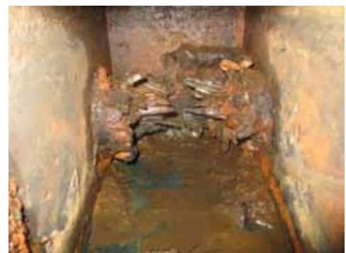
写真-1 PC鋼材腐食破断状況
