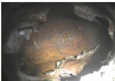
写真-1 PC 鋼材の腐食状況
