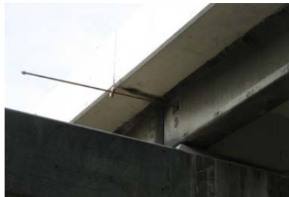
写真-2 PC 鋼棒突出事例
