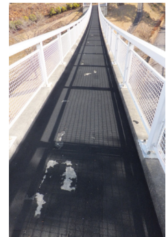
写真-3 舗装の損傷
