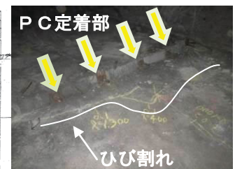
写真-1 PC定着部背面のひび割れ
