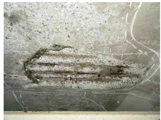
写真-1 床版下面の劣化状況
