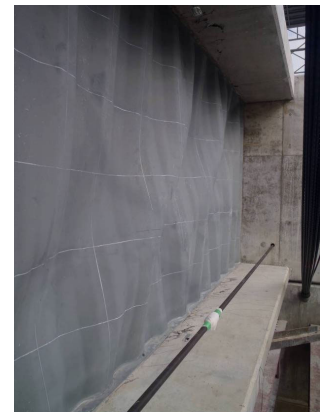
写真-3 座屈状況
