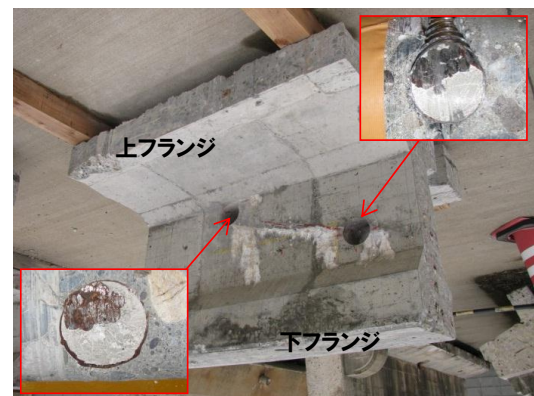
写真－1 桁腹部シース沿いひび割れ
