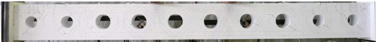
写真-1 長期荷重時ひび割れ発生状況
