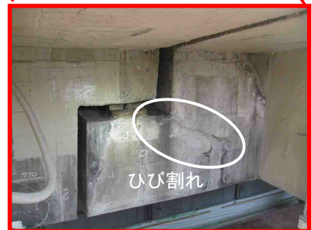
写真-3 受台損傷 (他工事の例)
