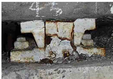
写真-2 支承損傷事例 (当該箇所)
