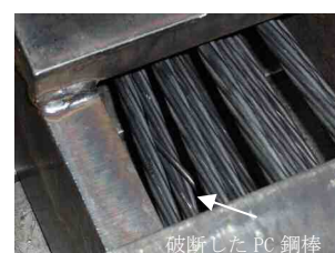
写真-6 緊張後 (破断状況)
