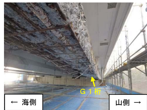
写真-2 PC鋼材破断状況
