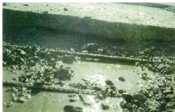
写真-1 床版コンクリートの劣化状況
