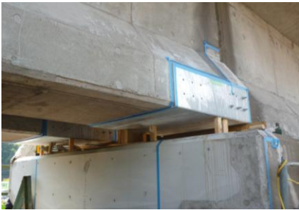
写真-4 主桁の補強鋼板
