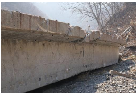
写真-1 主桁の斜めひび割れ
