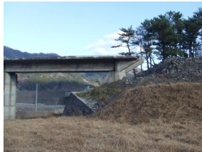
写真-2 背面盛土の流失
