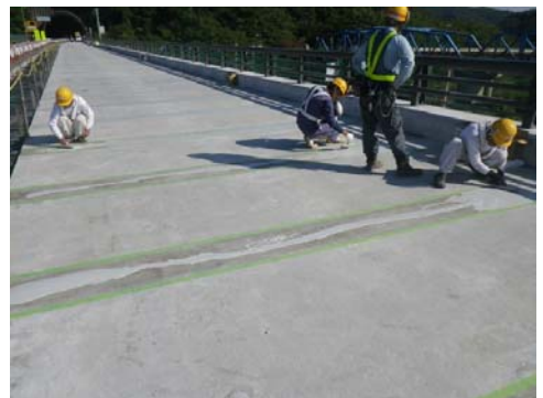
写真-4 水性エポキシ樹脂配合複合塗膜防水材料の塗布状況
