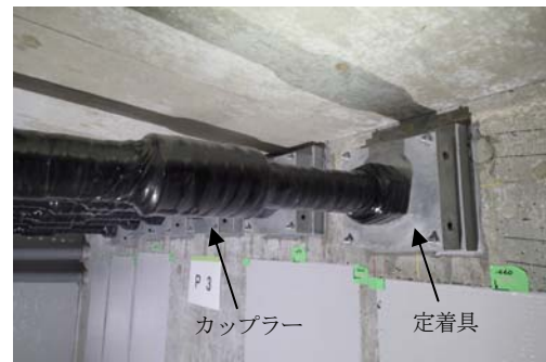
写真-3 柱頭部外ケーブル配置
