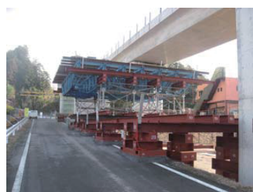
写真-3 段差鋼材
