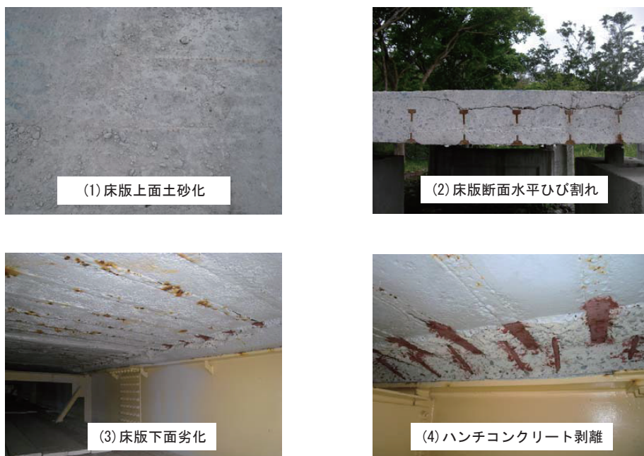
写真-2 既設床版劣化状況
