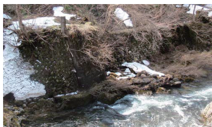
落橋した左岸径間
