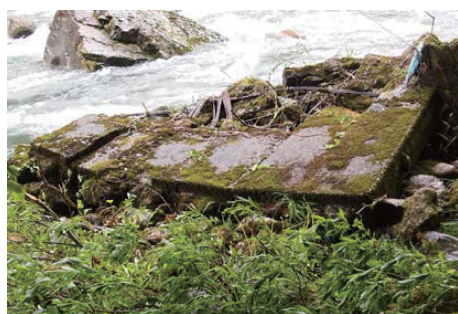
落橋した主桁の状況
