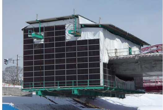
写真-3 ワーゲンの外観
