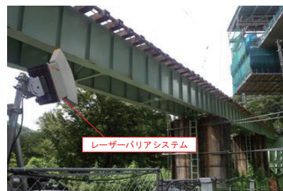
写真-3 レーザーバリアシステム
