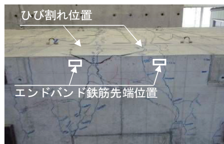
写真-4 供試体の破壊状況
