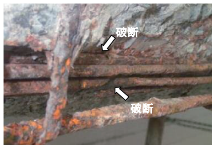
写真-1 PC 鋼線の破断状況
