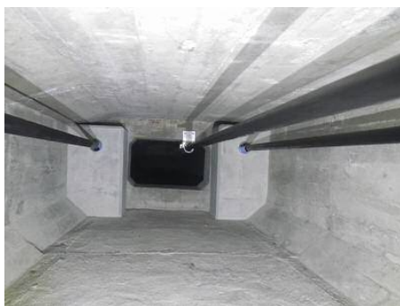
写真-1 箱桁内ケーブル配置
