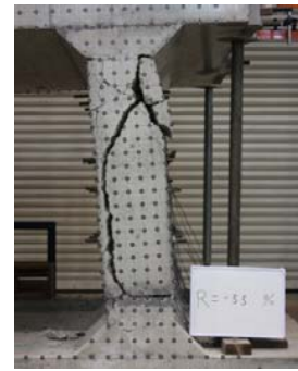
写真-5 南側壁の損傷の様相(左) R=-5.5%
