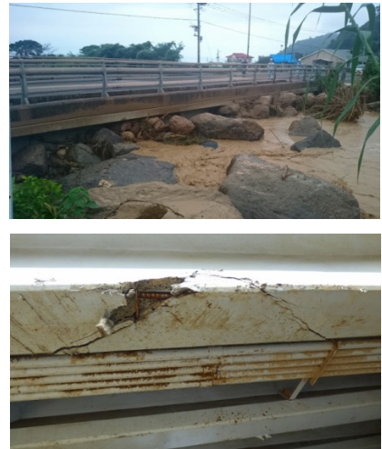
写真-1 被災状況 (2015年6月24日)
