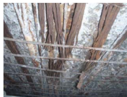
写真-1 PC鋼材の破断事例 1)
