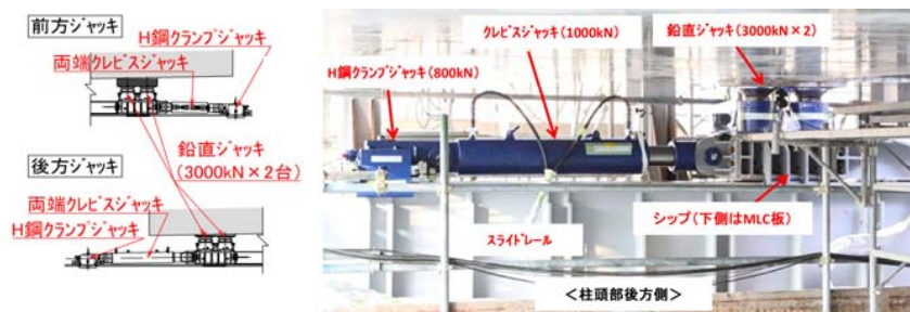
図-4 押し出し用ジャッキ設備
