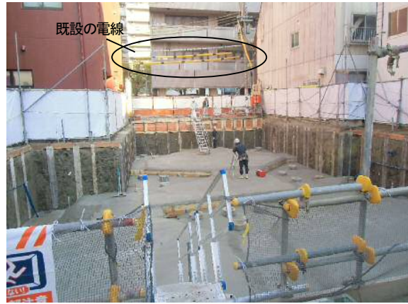
写真-1 敷地と電線位置関係 (北面)
