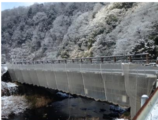
写真-1 寒中条件下で加温養生を行って施工した橋梁の一例
