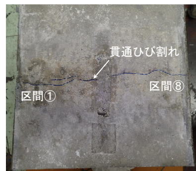
写真-1 かぶり面の腐食ひび割れ状況
