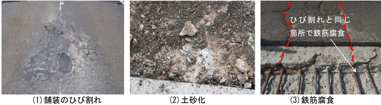
写真-2 床版上面の劣化状況
