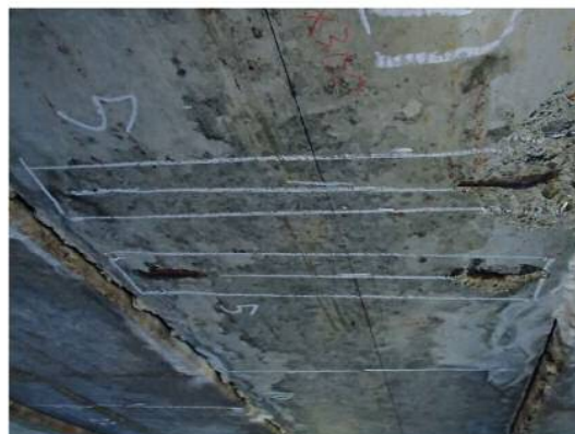
写真-2 鉄筋かぶり不足部
