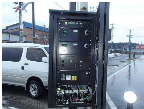
写真-7 直流電源装置
