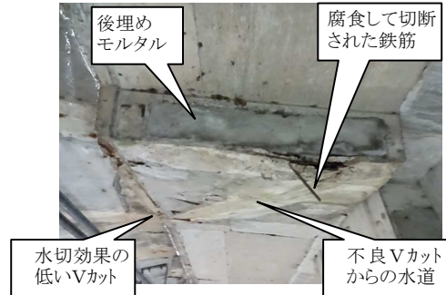
写真-3 突起部損傷状況
