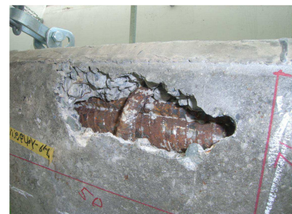
写真-6 主桁下縁空隙状況
