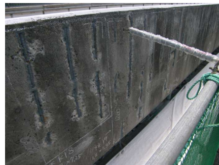
写真-1 壁高欄損傷状況
