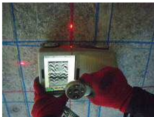
写真-4 高性能電磁波レーダー
