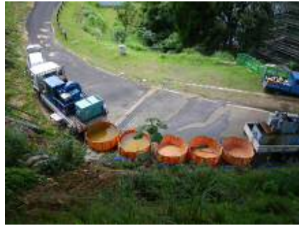
写真-8 WJプラント全景
