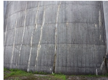
写真-2 ひび割れ
