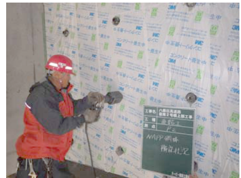
写真-3 NAPPユニット解放状況
