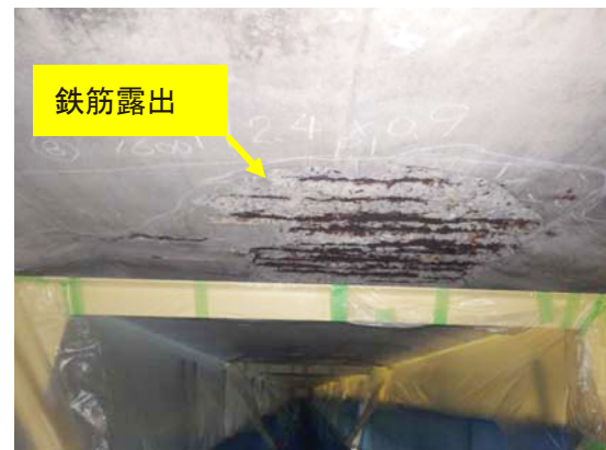
写真-2 既設床版下面劣化状況
