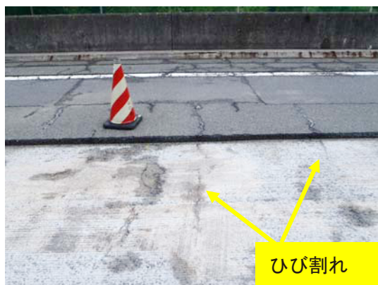
写真-1 既設床版上面劣化状況
