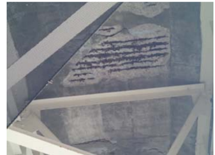
写真-1 床版下面の劣化状況
